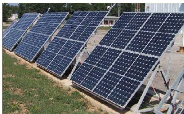
Figure 6 – Batterie de panneaux photovoltaïques.
