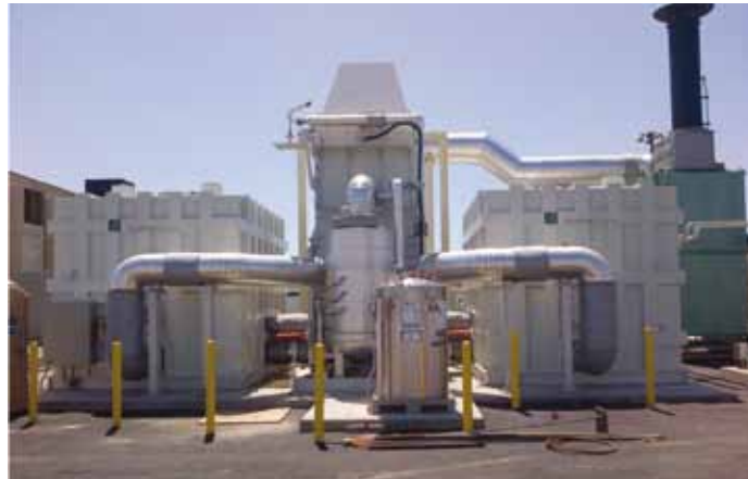
Figure 2 - Usine de traitement des eaux usées à base d'un système de pile à combustible à carbonates fondus de 2,8 MW (DFC 3000, Fuel Cell Energy aux États-Unis) pour la production d'énergie « propre ».
