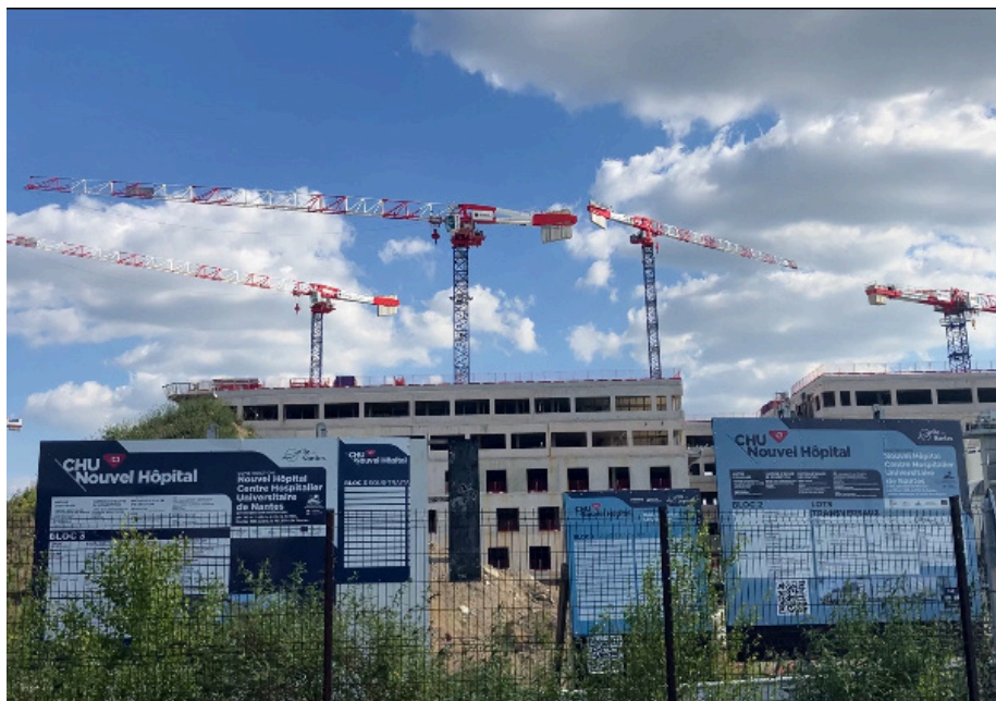
Le futur CHU de Nantes, construit avec du ciment 100% bas carbone. Crédits photo: Morgane Anneix et Juliette Laffont.
